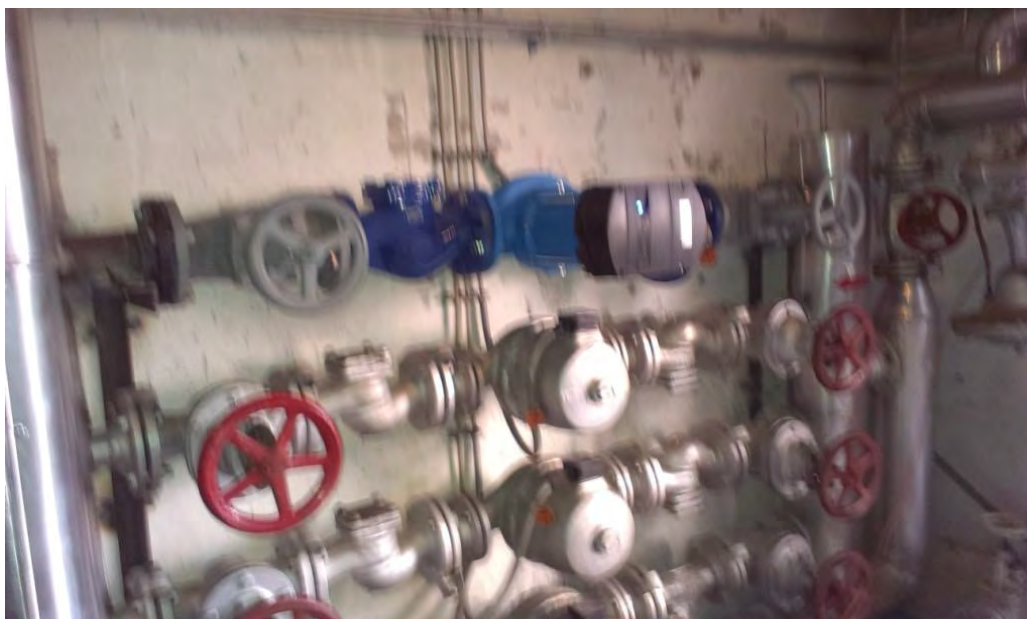
Slika 6. Cirkulacijske pumpe toplinske stanice
