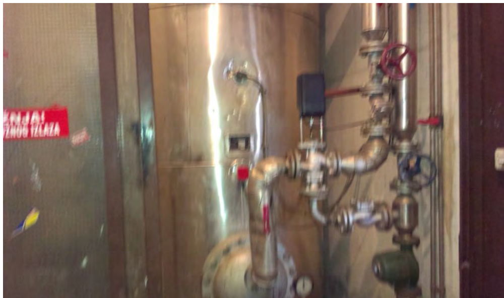
Slika 10. Cirkulacijske pumpe tople potrošne vode
