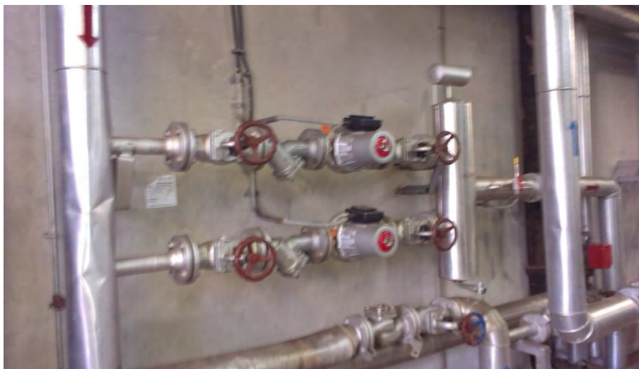
Slika 9. Cirkulacijske pumpe toplinske stanice
