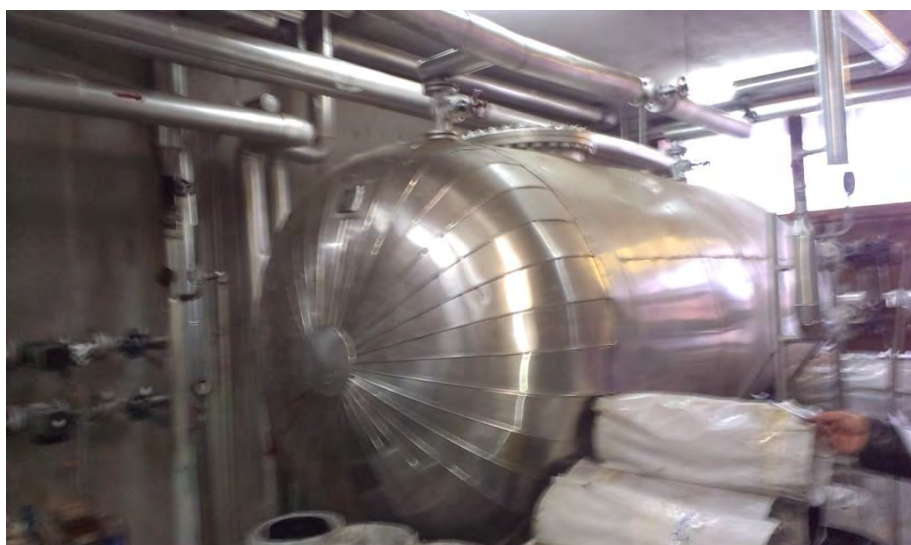
Slika 101. Spremnik potrošne tople vode
