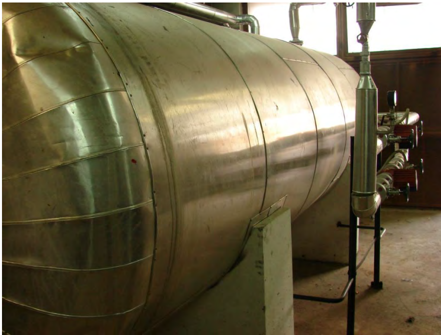
Slika 12. Spremnik potrošne tople vode
